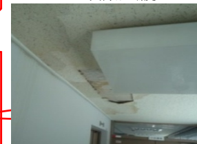
天井から漏水
