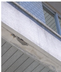
底部の一部崩落
