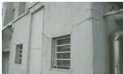
処遇管理棟 外壁の亀裂
